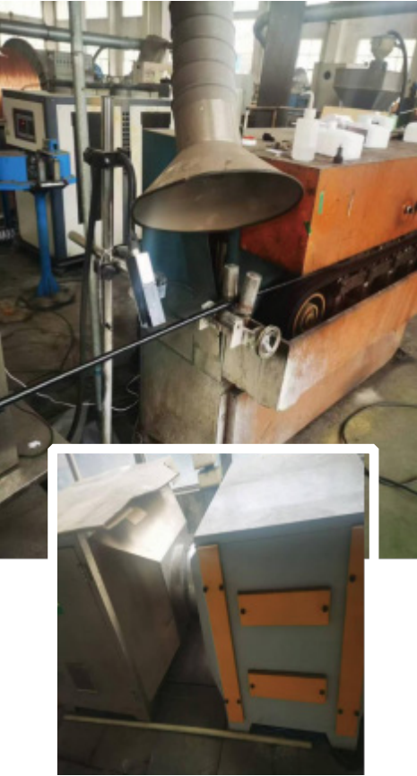
红峰电缆废气处理设备
